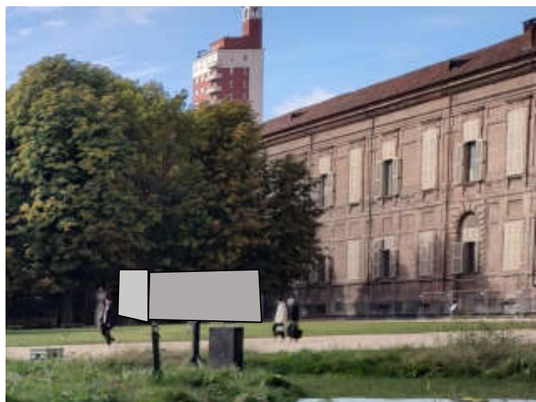
angolo giardino per zona logistica e baracche (Richiuse in recinzione con teli schermanti)
